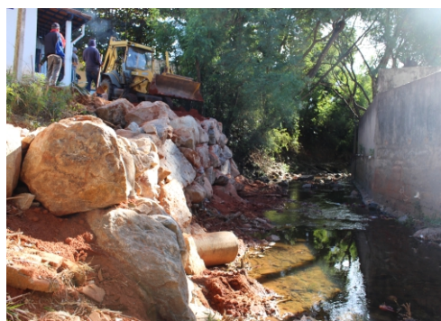
Perigo: com risco de desmoronamento, servidores restauram local
