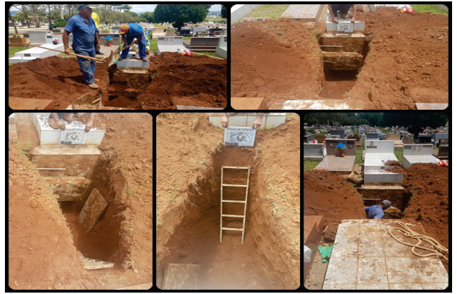
Cemitério: Falta de equipamentos e os riscos de soterramento continuam.
